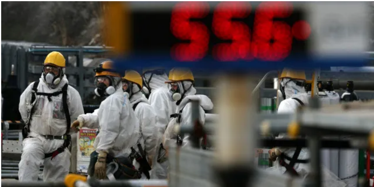
Januar 2026: Weiterhin laufende Stilllegungsarbeiten an den Reaktorblöcken 2 und 3, eine Messstation zeigt die aktuelle Strahlung an | Bild: picture alliance / REUTERS / Issei Kato
